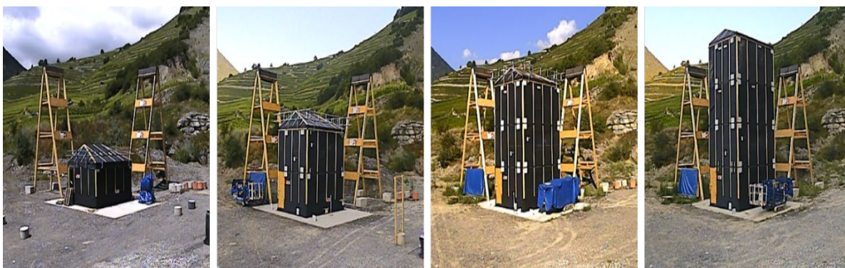
Abb. 2: Etappenweises Aufrichten und Testen am Testgebäude in Chamoson (VS), von Mai bis Oktober 2019
