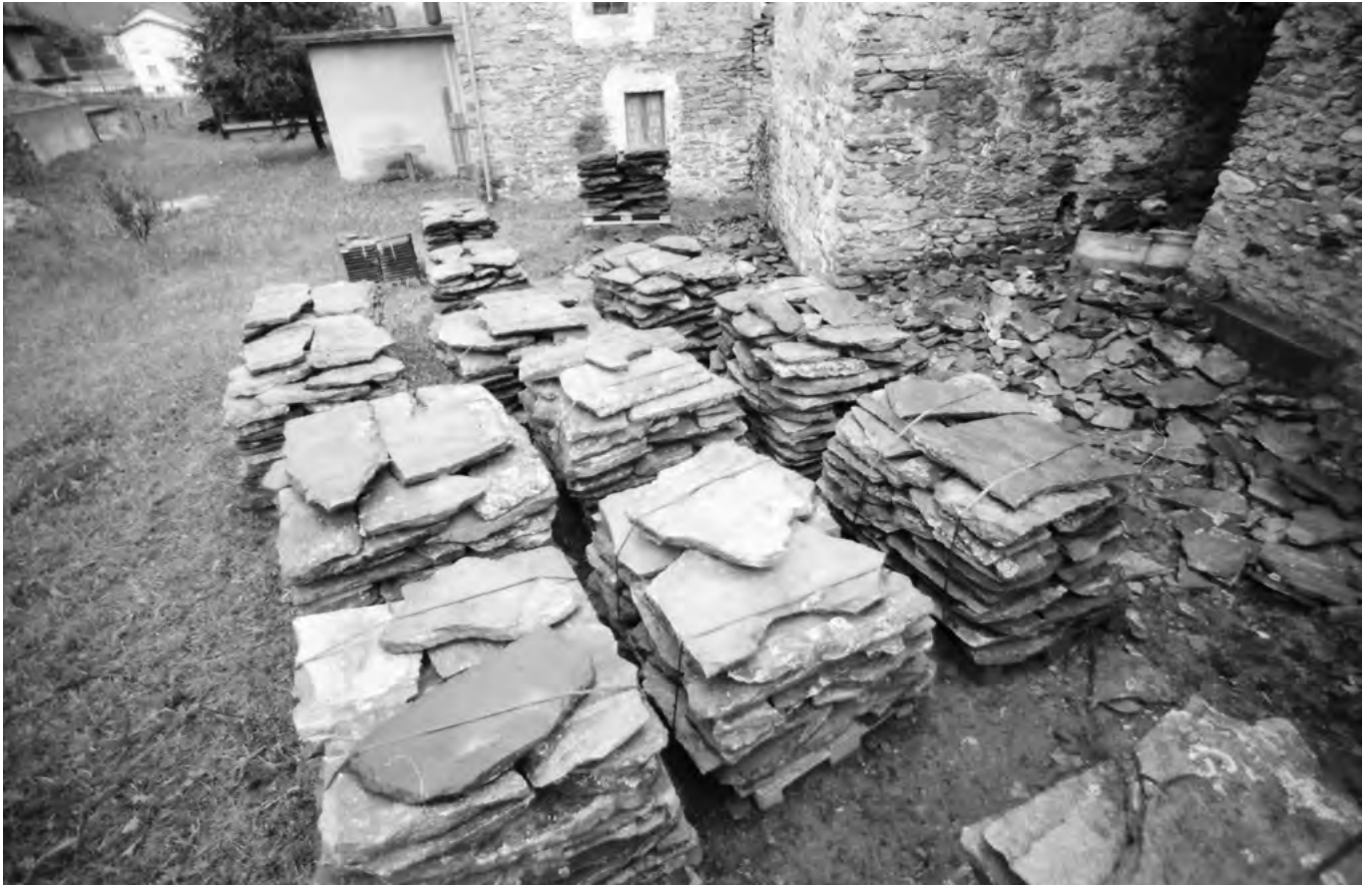
45 Cugnasco, Wohnhauskomplex: Abbauarbeiten im Mai 2000. Sauber gestapelt und sortiert wurden die abgebauten Dachplatten zum Transport ins Museum bereitgestellt. Aufnahme 2000.
