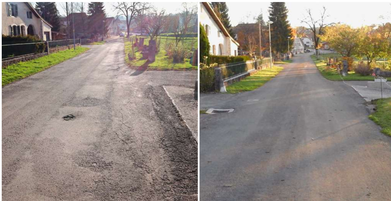
7 | Photo avant/après entretien d'un axe où la commune a opté pour la pose d'un enrobé à froid 7 | Foto vor/nach Instandhaltungsmassnahmen an einer Verkehrsachse, bei denen die Gemeinde sich für den Einbau von Kaltmischgut entschieden hat.
