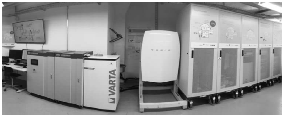
Bild 1: Prosumer-Lab Testumgebung im Labor des BFH-CSEM-Zentrums Energiespeicherung
