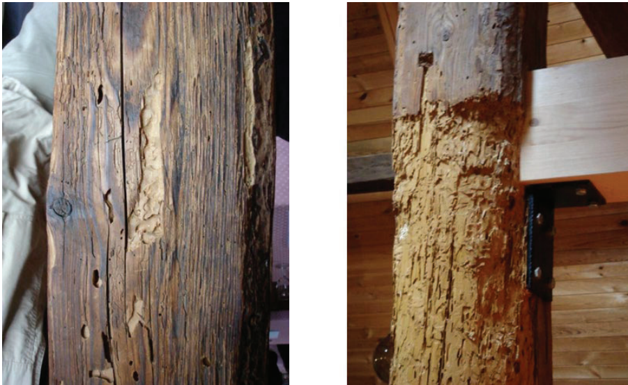
Abb. 6: Schadensbild des Hausbocks an einem Pfosten in einem ausgebauten Dachstock
