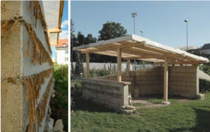
Abbildung 2: Auf dem Gurzelenareal (ehemaliges Fussballstadion) in Biel wurde aus Rohlehm ein Pavillon in Echtgrösse gebaut und einzigartige architektonische Lösungen erprobt.
