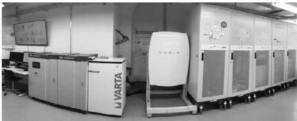
Bild 1: Prosumer-Lab Testumgebung im Labor des BFH-CSEM-Zentrums Energiespeicherung
