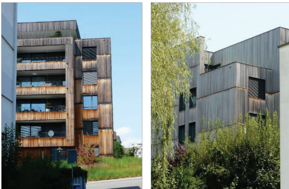
Abb. 7 Einfluss der (unregelmässigen) Bewitterung auf das Vergrauen bei Holzfassaden; Mehrfamilienhaus Steinhausen; Scheitlin Syfrig Architekten, Luzern (Baujahr 2006; Fotos 2012; HP. Kolb; links: Süd-West-Fassade, rechts: Nord-Ost-Fassade)
