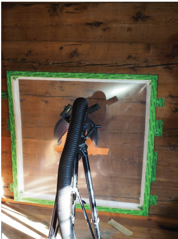
Abb. 2: An der Aussenwand montierter Messrahmen des MLM-Messgerätes
