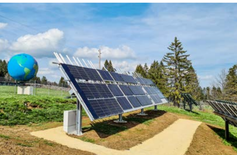
Kommerzielle Stromproduktion war nie Zweck des Kraftwerks auf dem «Sonnenberg».
