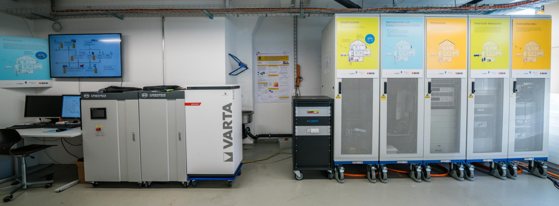
Monitoring Heimspeicher (Lithium-Ionen-Batterien) Energiemanager Prosumer-Haushalt
