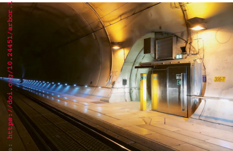
Wenn ein Hochgeschwindigkeitszug durch eine enge Tunnelröhre rast, entstehen Druck- und Sogwellen von gewaltiger Kraft. Bei jeder Durchfahrt wirkt sich diese Kraft auf die in regelmässigen Abständen eingebauten Fluchttüren aus. (Bild: Elkuch Group)
