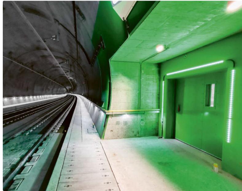
Fluchttüren in Bahntunneln müssen jahrzehntelang zuverlässig funktionieren, damit die Sicherheit der Fahrgäste in Notfallsituationen gewährleistet ist. (Bild: Elkuch Group)
